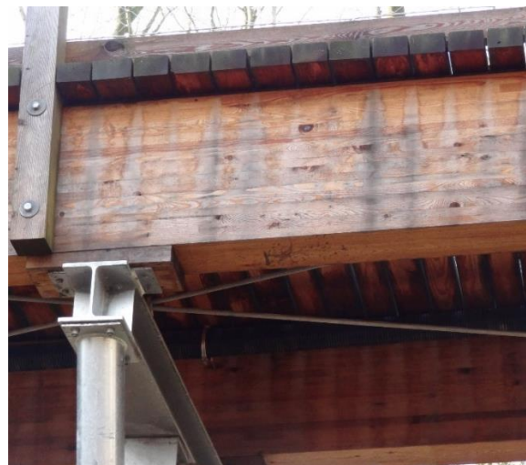
Abbildung 7: Wasserflecken durch zu wenig Überstand (nicht von WIEHAG ausgeführt)
