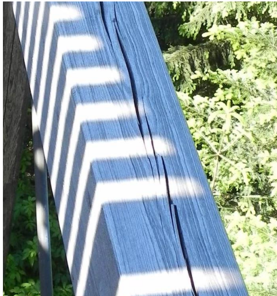
Abbildung 15: Wassersackbildung durch fehlen von Abdeckung (nicht von WIEHAG ausgeführt)
