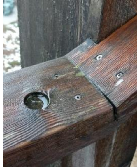
Abbildung 17: Wassersackbildung bei Ausbesserung (nicht von WIEHAG ausgeführt)
