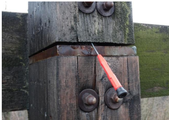
Abbildung 11: Fehlerhafter Anschluss des Stützenstoßes (nicht von WIEHAG ausgeführt)
